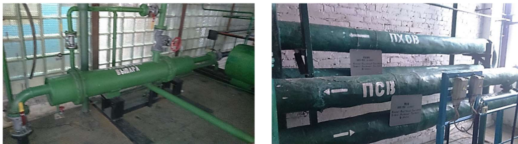
Рисунок 10 – Трубчаті теплообмінники водопідготовки котельні РК «Молодь»
