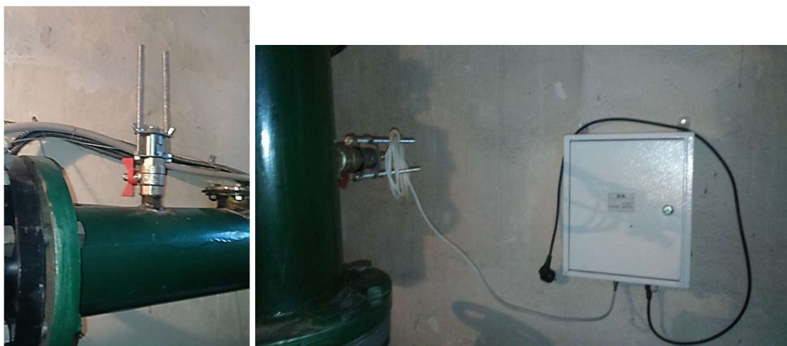
Рисунок 3 – Обладнання на котельні «Макіївська»
