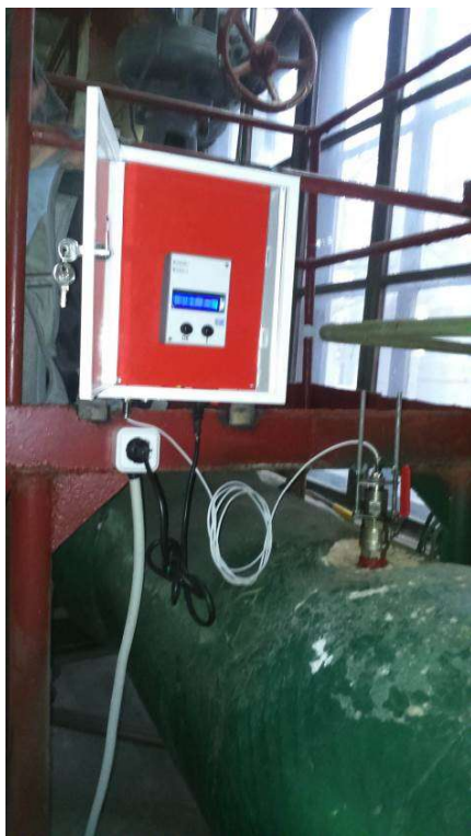
Рисунок 2 – Обладнання на РК «Нивки»
