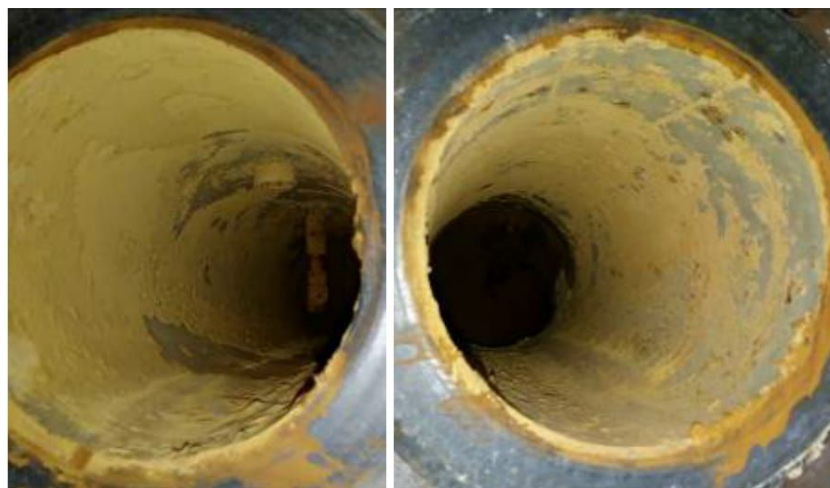
Рисунок 13 – Фото внутрішньої поверхні трубопроводу котельні “Макіївська”, вкритого шаром осаду продуктів корозії.
