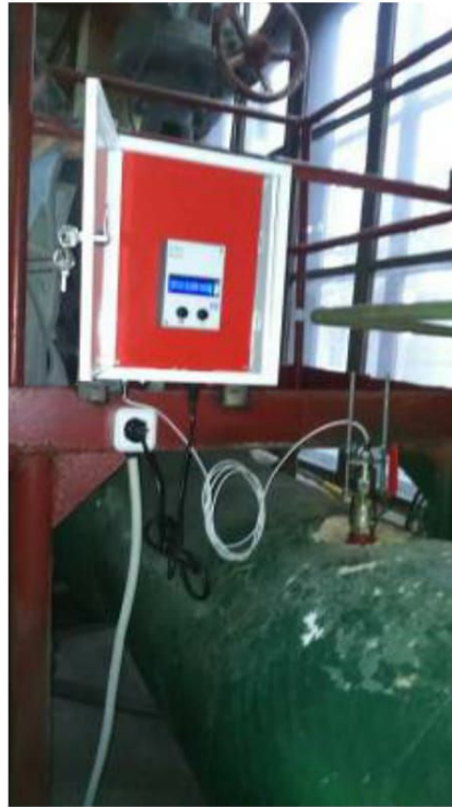
Рисунок 7 – Обладнання на РК «Нивки»
