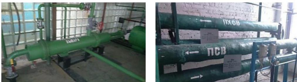
Рисунок 19 – Теплообмінники водопідготовки котельні РК «Молодь»
