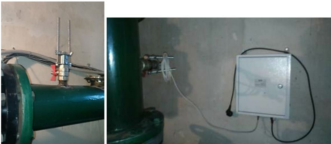
Рисунок 8 – Обладнання на котельні «Макіївська»
